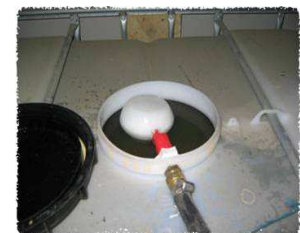
Contrôle du remplissage de la réserve d'eau par flotteur
