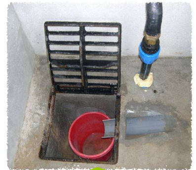
Bac de récupération des fuites d'effluents
