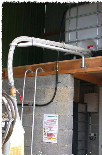
Réserve d'eau intermédiaire avec potence
